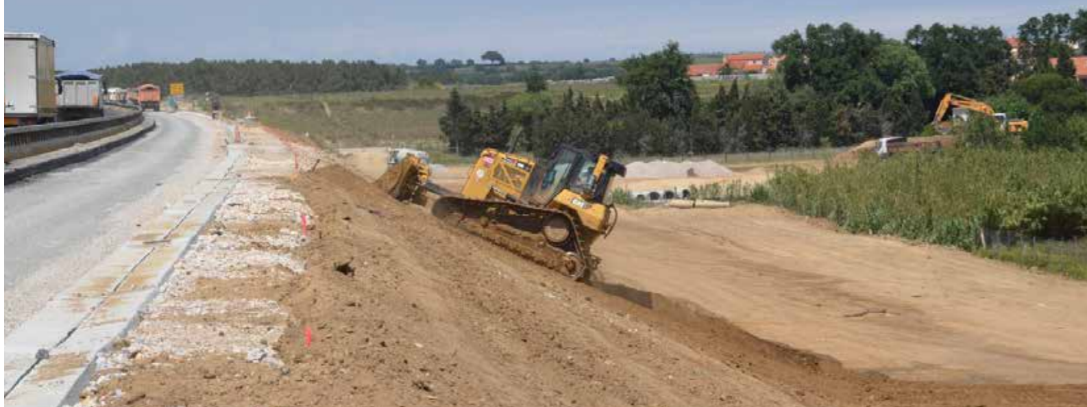
UN BULLDOZER VÉGÉTALISE LES TALUS POUR RECEVOIR LES SEMENCES D'HERBE ET OU LES PLANTATIONS
